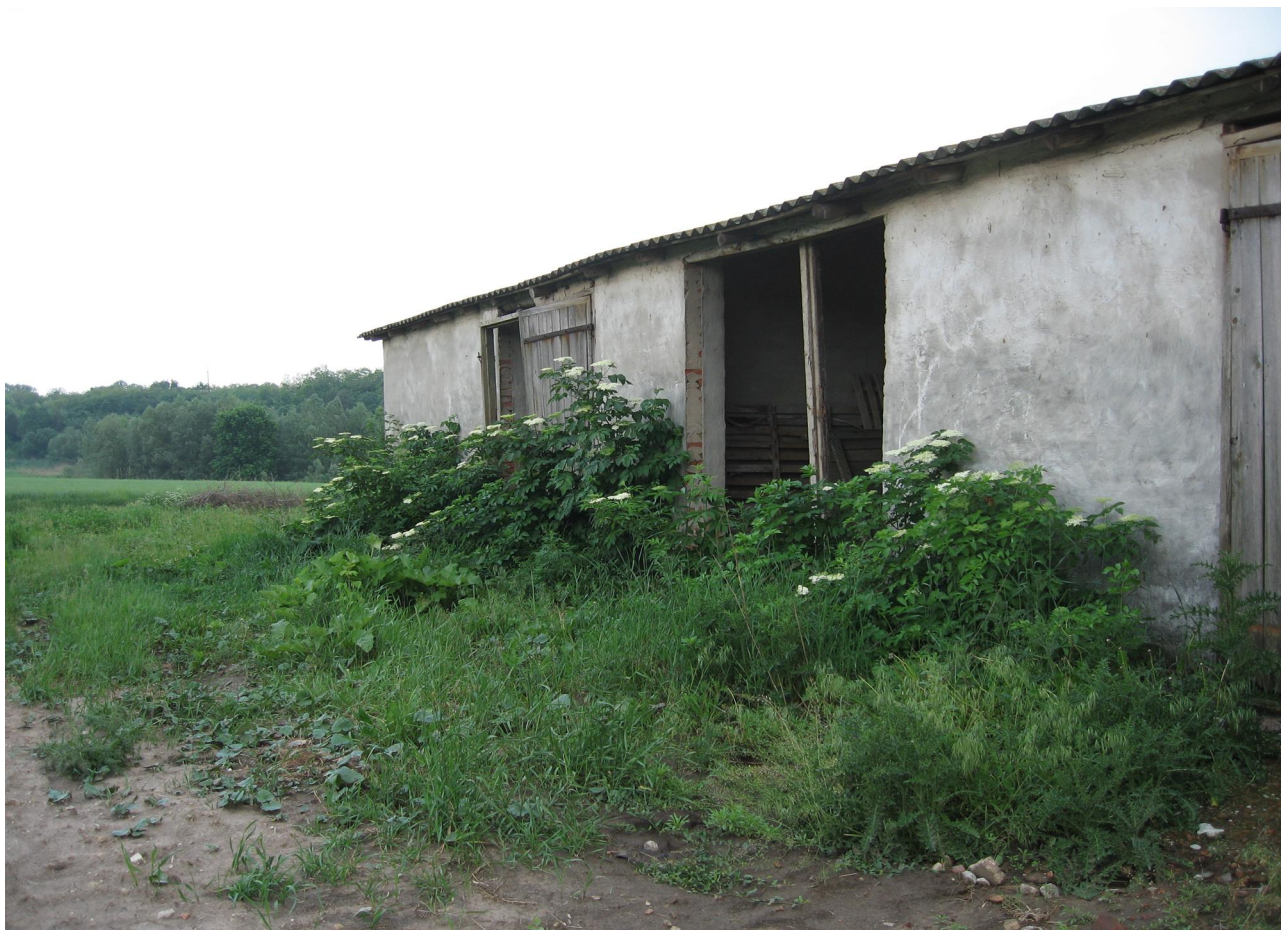
Рис. Загальний вигляд складу непридатних пестицидів
